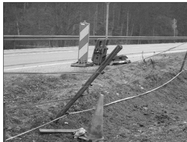
Abbildung 4: Fehlende Wartung und falsches Zaunmaterial an einer stark befahrenen Straße
